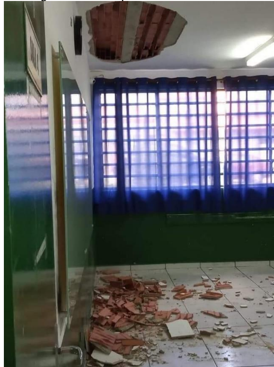
Figura 10 – Desprendimento de reboco
