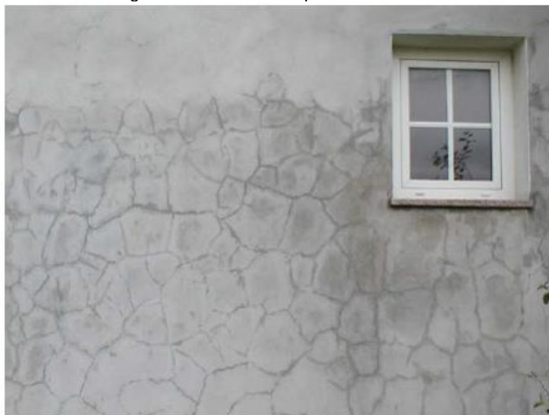
Figura 7 - Fissuras em parede rebocada
