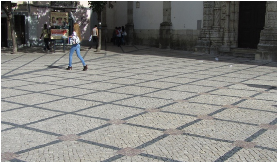
Figura 4.8: Piso com espaçamento entre os quadrados
