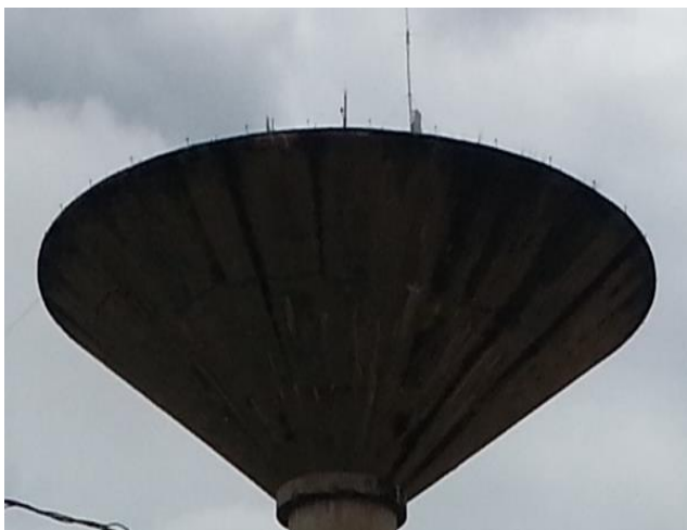
Figura 4.4.15: Parte do reservatório de água do DEPASA em Rio Branco, Acre.
