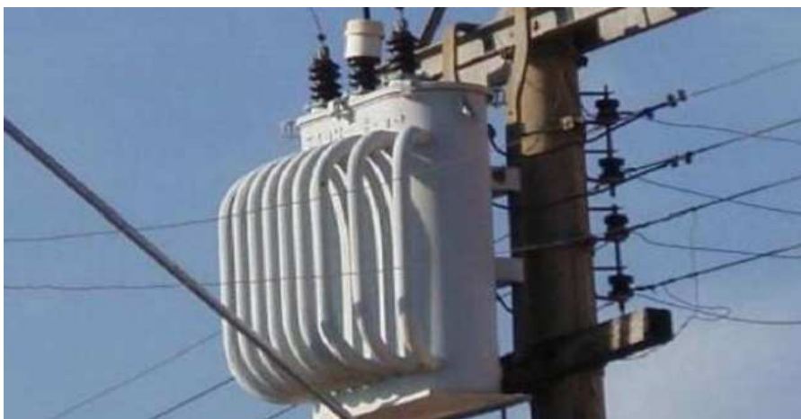
Figura 6.7: Transformador em um poste de luz
