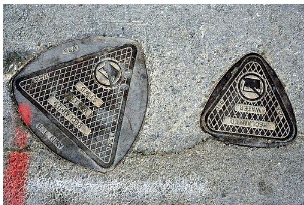
Figura 6.10: Tamba de esgoto
