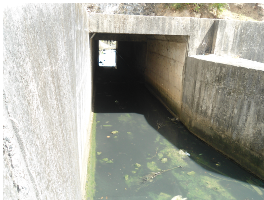
Canal de esgoto sanitário no formato de um paralelepípedo de base quadrada
