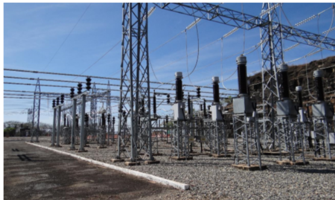
Figura 2.2: Foto pátio da subestação de Emborcação (Catalão - Goiás) [2].
