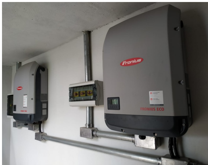
Figura 2.6: Inversor fotovoltaico e sistemas de proteção
