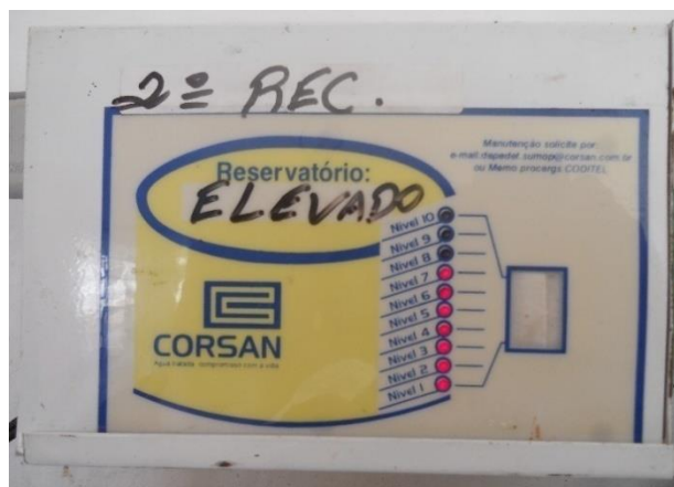
Figura 3.17 – Marcador de nível do reservatório elevado da ETA marcando nível 7.
