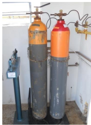
Figura 2.11 – Cilindros de cloro gás da ETA de Candelária/RS.
