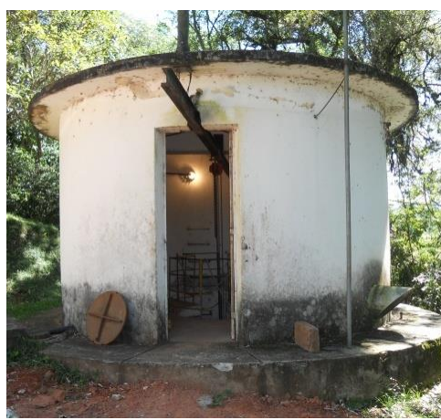
Figura 2.5 – Poço de bombas da captação de Candelária/RS.
