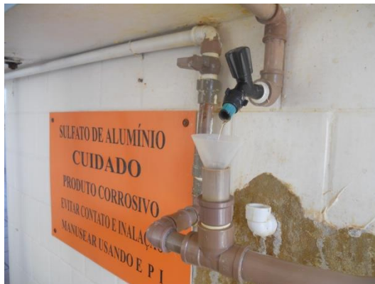
Figura 3.4 – Torneira de dosagem de sulfato de alumínio da ETA de Candelária/RS.
