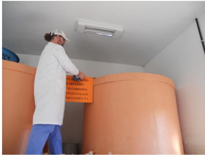
Figura 3.6 – Tina de dosagem de sulfato de alumínio da ETA de Candelária/RS.
