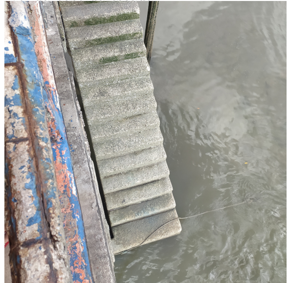
Figura 5.4: Volume de água chegando ao nível da base da escada
