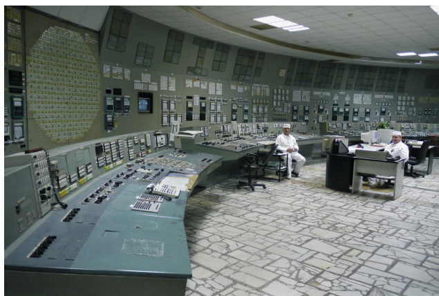
Figura 115 – Sala de controle da usina nuclear de Chernobyl
