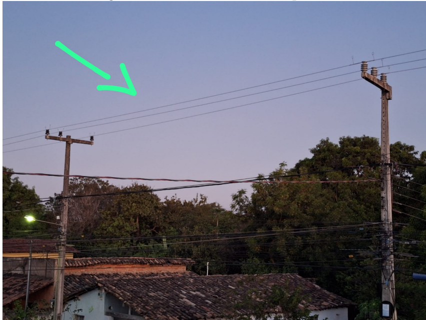
Figura 19: Rede Elétrica em postes
