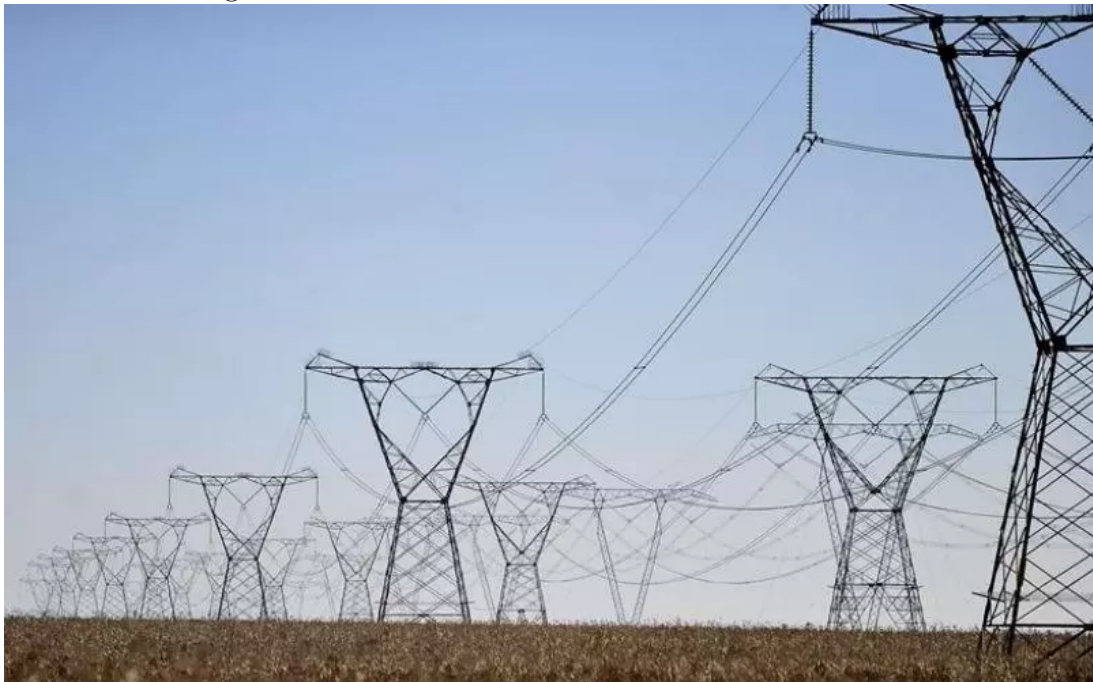
Figura 18: Rede Elétrica em Linha de Transmissão
