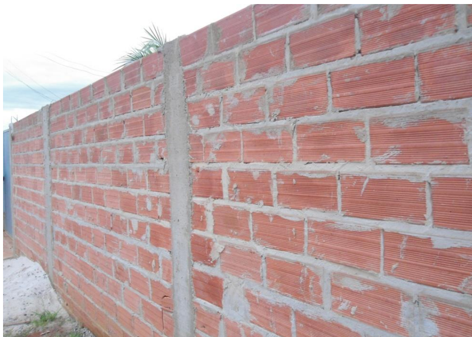
Figuras 41 - Muro de tijolos sem “chapisco”.
